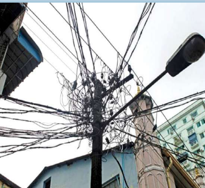
A Mini Electrification Line
